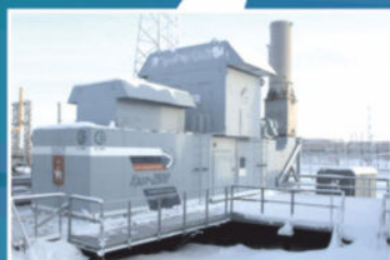
Газотурбинная блочно-транспортная электростанция ГТЭС «Урал-2500»
