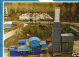
Газотурбинная электростанция «ГТЭС-4»
