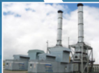
Газотурбинная блочно-транспортная электростанция ГТЭС "Урал-4000"
