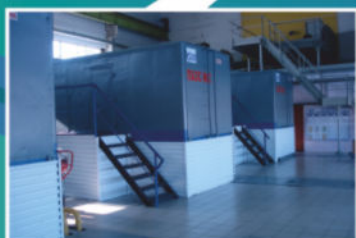
Передвижная автоматизированная газотурбинная электростанция «ПАЭС-2500М»
