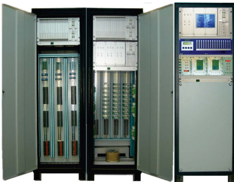
Устройство связи с объектом
